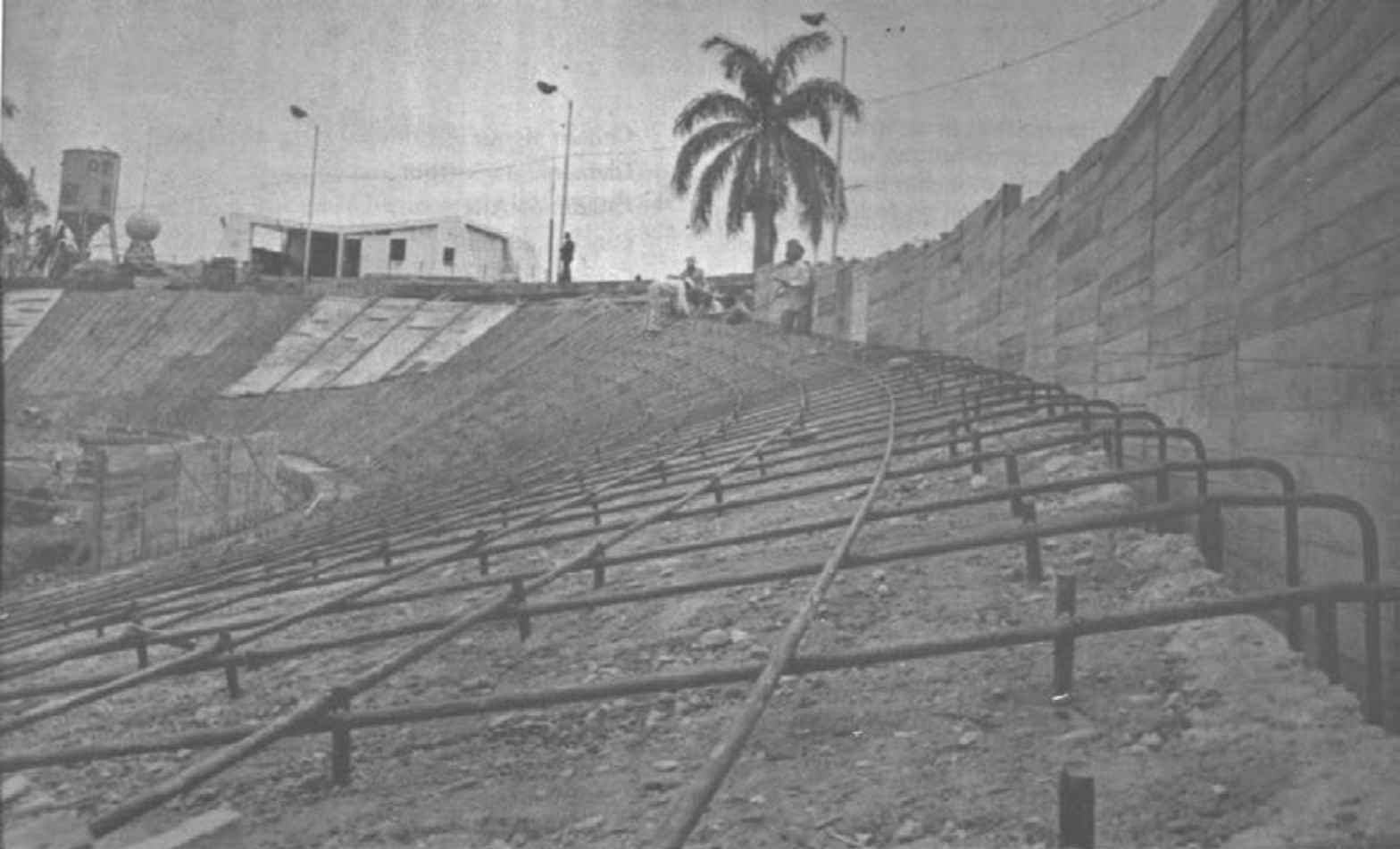
Etapa de remodelación del velódromo de Medellín, en donde se llevaron a cabo las pruebas correspondientes al torneo de ciclismo. Fue casi total la remodelación que hizo Corjuegos de este importante escenario deportivo.
