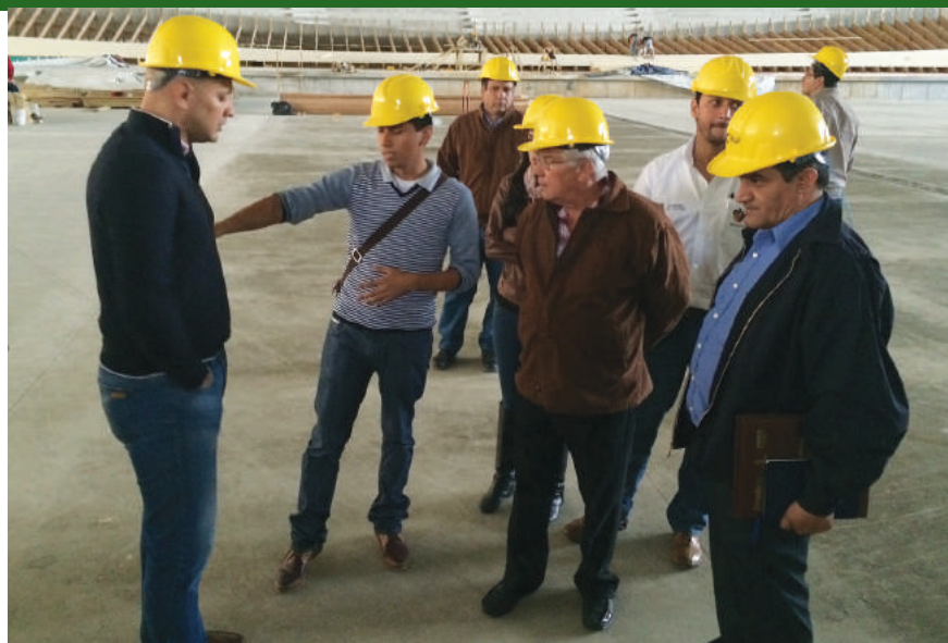
José Peláez DTI de ciclismo junto a Guillermo Rergis Borja inspeccionando la construcción del velódromo / José Peláez DTI of cycling with Guillermo Rergis Borja inspecting the construction of the velodrome.
